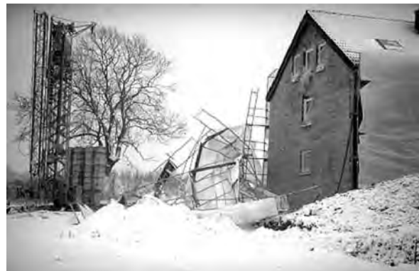
Abbildung 6: Gerüste nach einem Wintersturm
